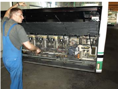
Fehlersuche, verursacht durch einen Blitzschlag
